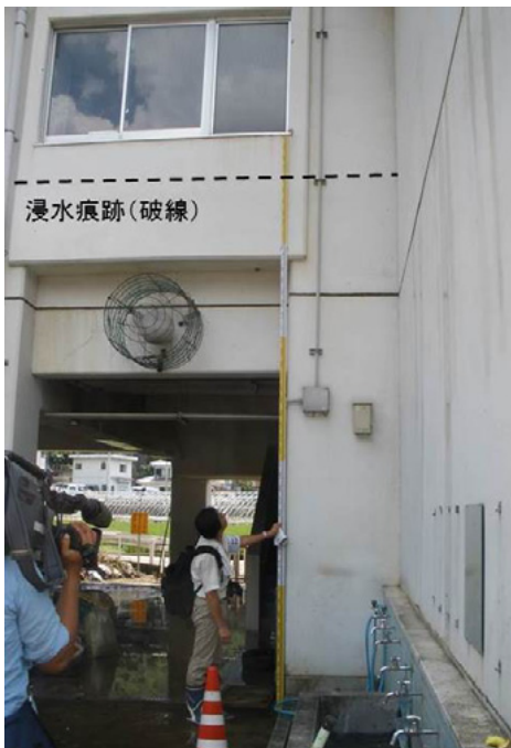
図2 阿南市立加茂谷中学校における浸水痕跡
