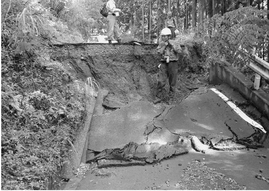
写真3 阿津江地区の斜面崩壊の上方斜面に生じた地すべりクラック (井内海俊撮影)
