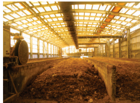
図3 実証実験を実施した二次発酵槽
