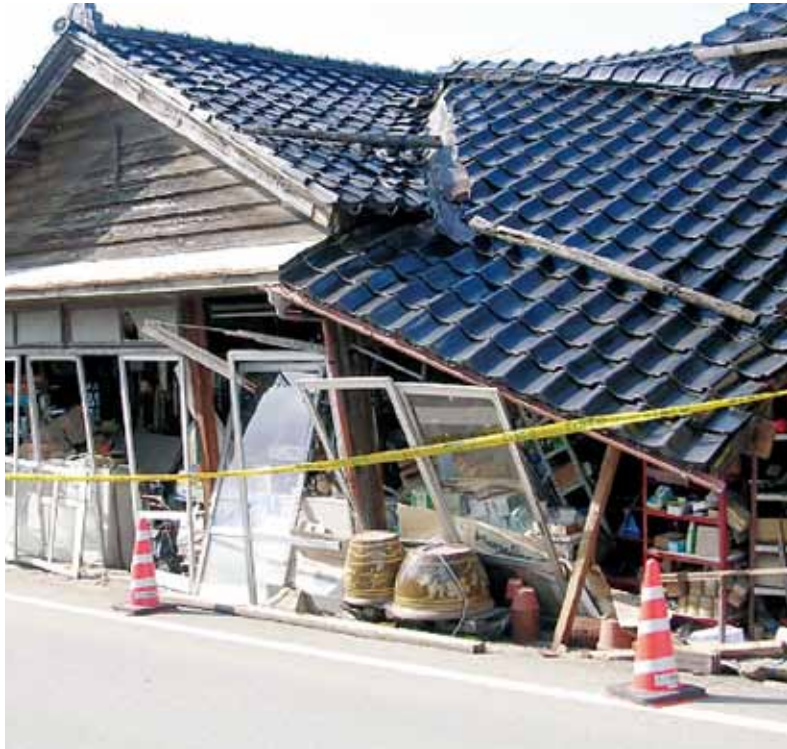
▲地震で倒壊した木造住宅
