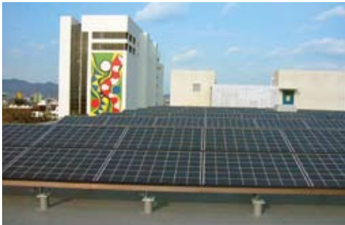
▲昨年度選定された取り組み＝今切倉庫屋上に太陽光パネルを設置(大塚倉庫)
