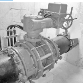
大谷配水池の緊急遮断弁
