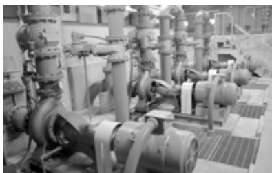
5 送水ポンプ できあがった水を配水池へポンプで送ります。
