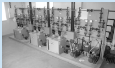
A 薬品注入設備(次亜塩) 水を消毒するための塩素剤を注入する設備です。
