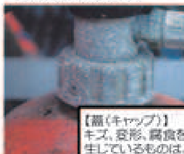
②あばた状の腐食
